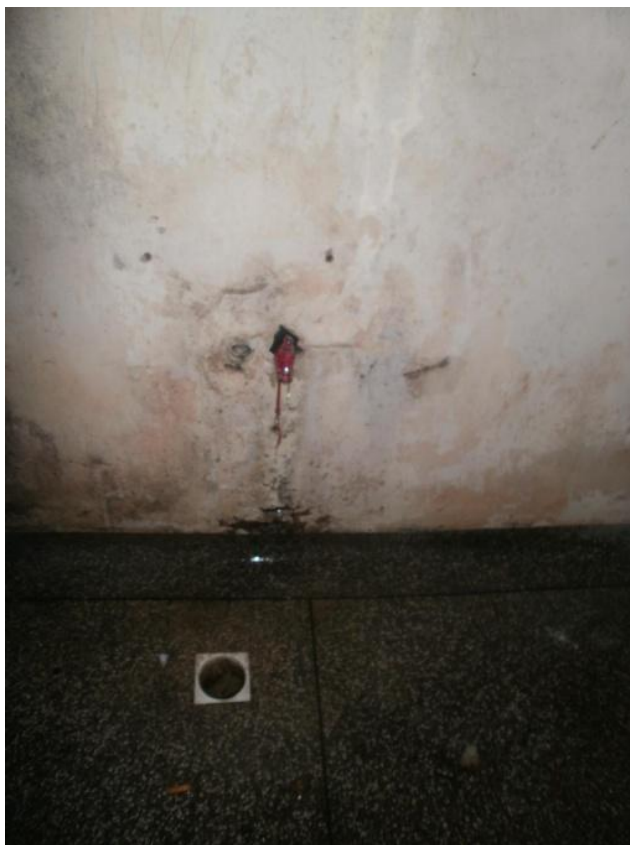
Imagem 12: Instalações hidráulicas do banheiro das celas.
