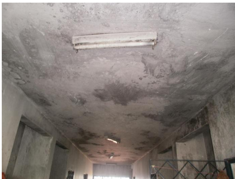
Imagem 10: Teto todo mofado devido a umidade do local.
